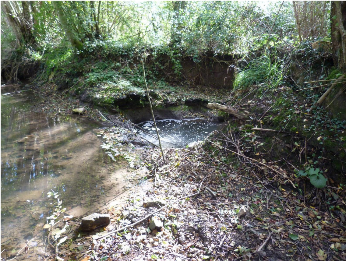
A droite effondrement du fond
